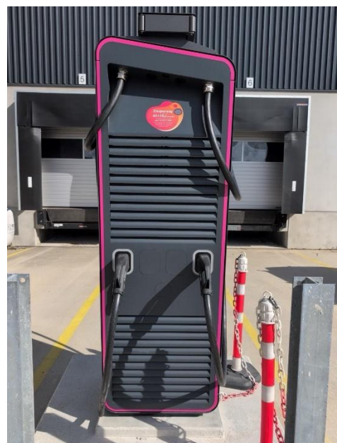
Abb. E. 3: Ladesäule für E-Lkw finanziert aus dem Inhouse-Klimafond.
